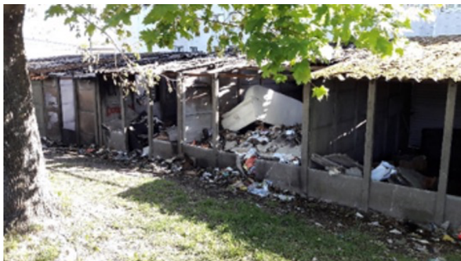
Figure 17 - Photographie des boxes dégradés et dépôts sauvages associés.
